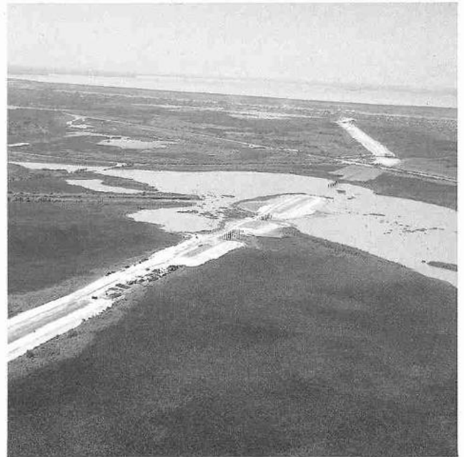
Construcción de plantillas de trabajo y cuerpo de terraplén sobre la zona de lagunas. Abajo, construcción de cuerpo de terracerías del entronque.
