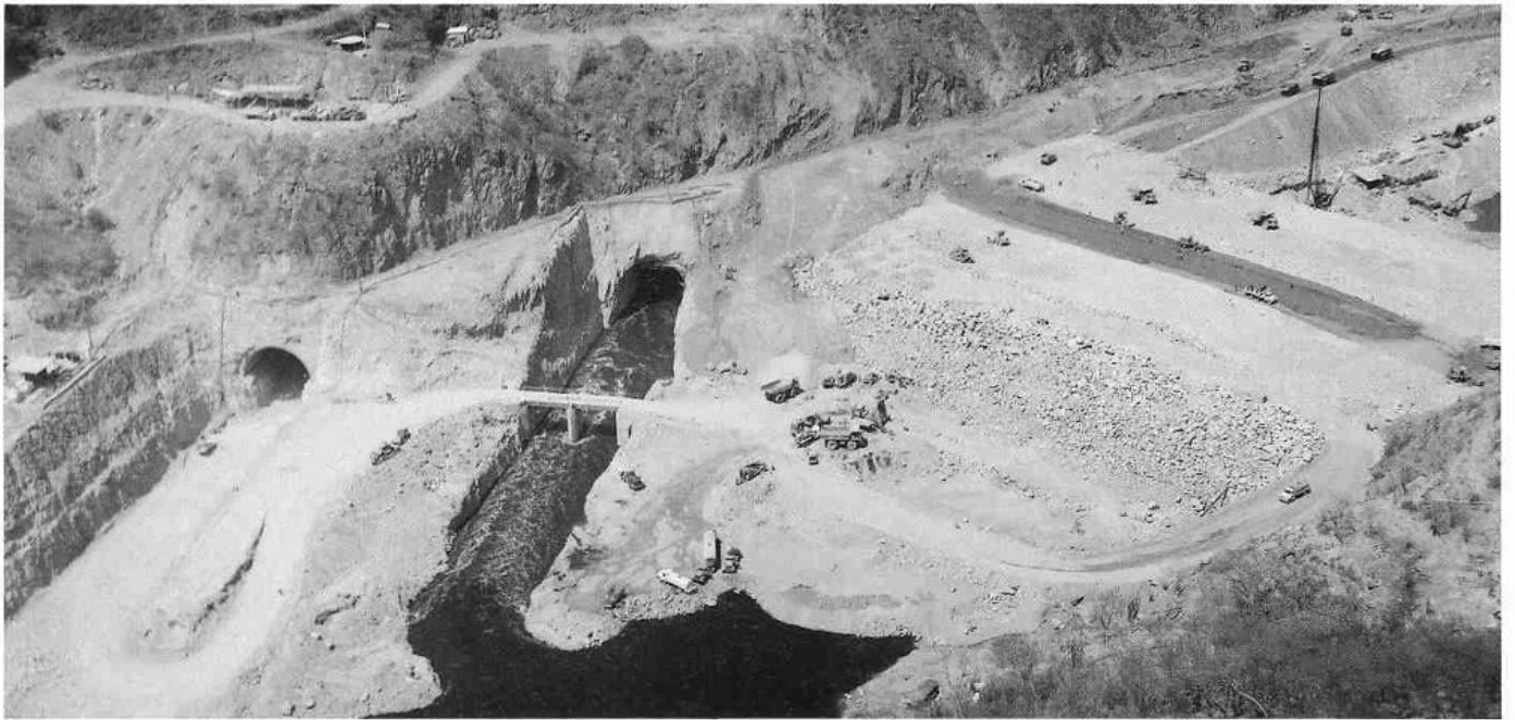
Panorámica de los portales de los túneles de desvío y de los trabajos en ejecución en la ataguía aguas arriba.
